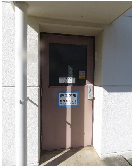
写真 2.2.1-2 コールド機械室入口扉・キーレックス
