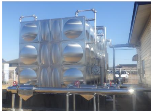
写真 2.12.15-2 上水受水槽(更新後)
