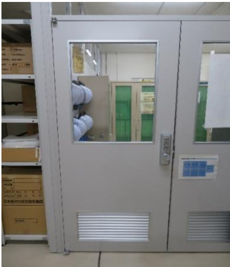
写真 2.2.1-1 居室出入口扉・キーレックス
