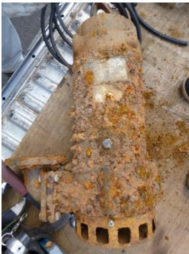
写真 2.2.5-1 排水ポンプ 更新前
