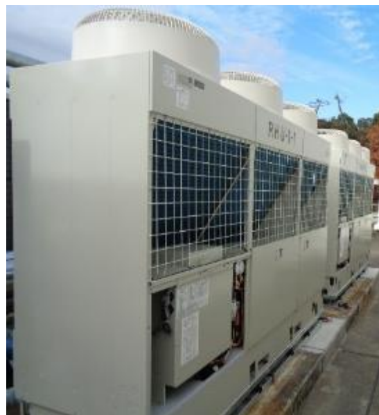
写真 2.2.9-2 チラー温水器 更新後
