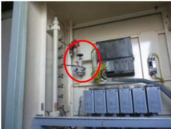
写真 2.2.6-1 エアフィルタ 設置前
