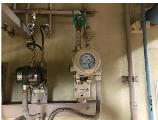
写真 2.2.12-1 微差圧伝送器 更新前
