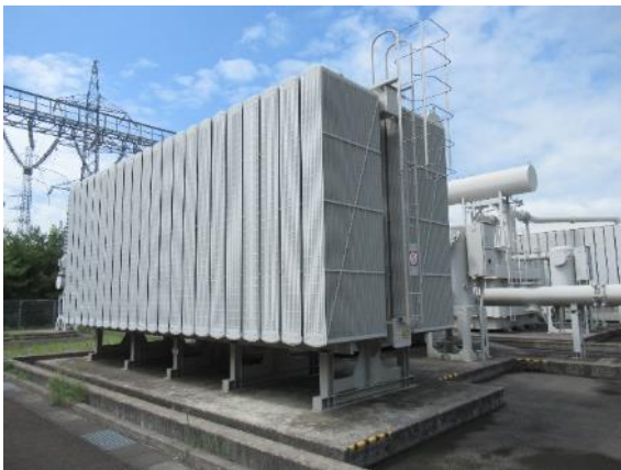
写真 2. 2. 18-3 No. 2 変圧器用放熱器（全体）
