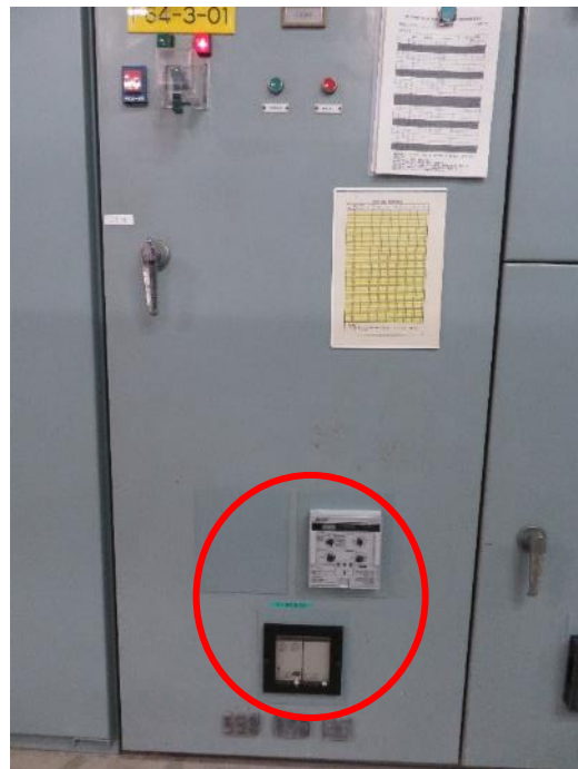
写真 2.2.4-2 静電型継電器 更新後
