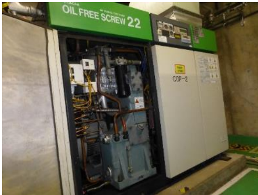
写真 2.2.7-1 空気圧縮機 No. 2
