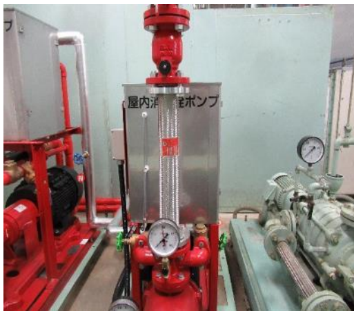
写真 2.2.15-1 屋内消火栓ポンプ更新後
