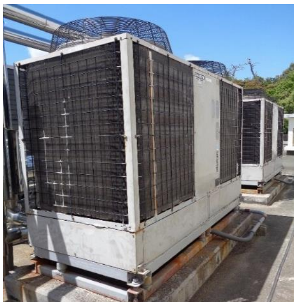
写真 2.2.9-1 チラー温水器 更新前
