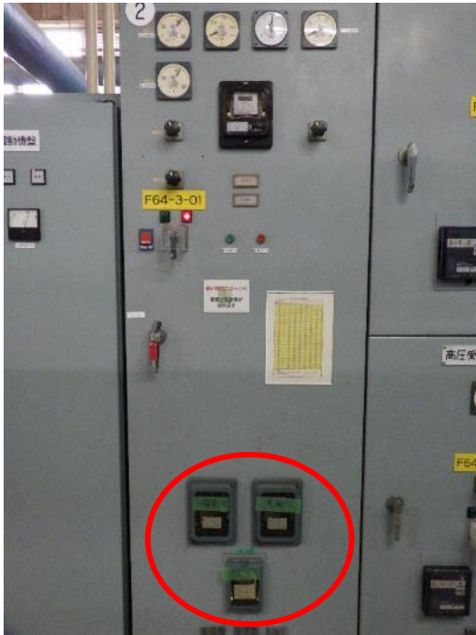
写真 2.2.4-1 誘導型継電器 更新前
