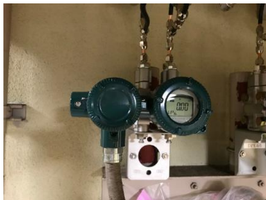
写真 2.2.12-2 微差圧伝送器 更新後
