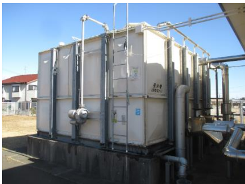
写真 2.12.15-1 上水受水槽(更新前)
