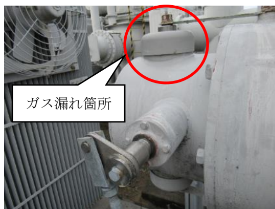
写真 2.2.18-1 ガス絶縁開閉装置メガリング端子
